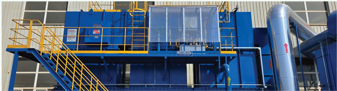
RTO 有机废气处理设施
